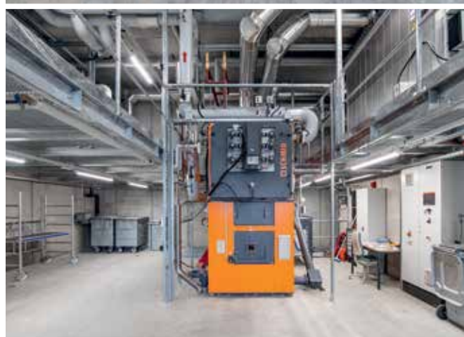
Nelle foto sopra la nuova centrale termica.
